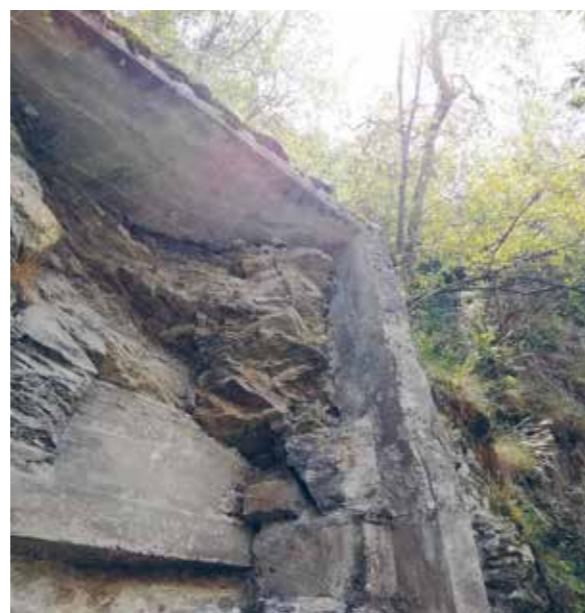
Schliessluken beim Schützenportal 2
