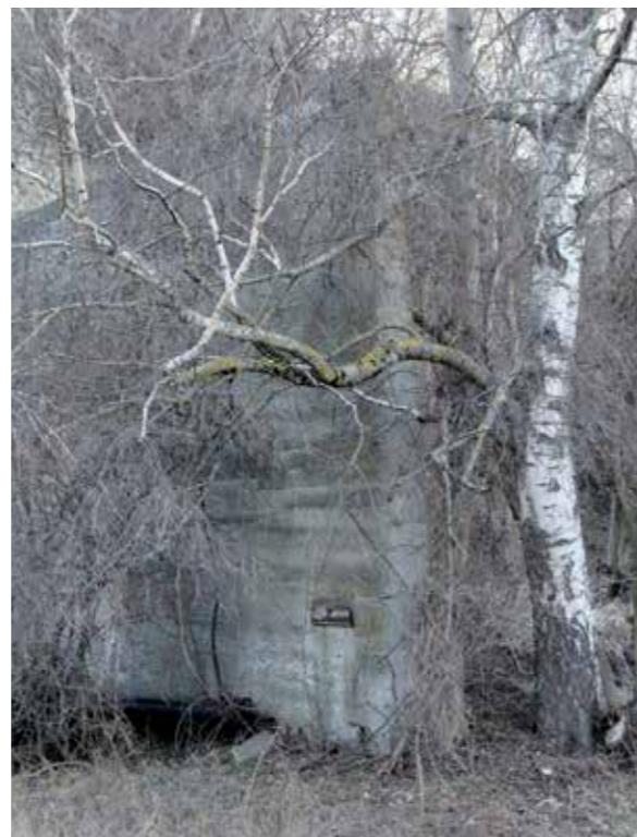
Die Natur holt die Stützmauer ein (Foto 2023)
